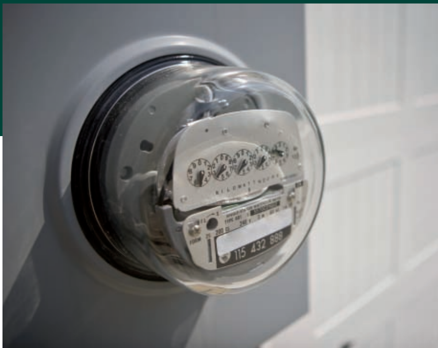
Contador de gas y electricidad.
